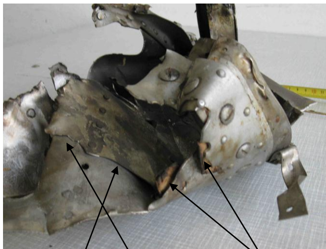
Rys. 46. Widoczne (brązowy kolor) przekładki tekturowe (!) pod złączeniem z licznymi nitami i śrubami. Widoczna od środka nietypowa nakładka (urwana?).
